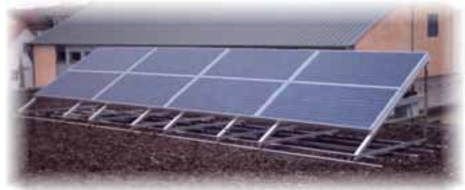
Photovoltaikanlage auf dem Dach der Ostertor-Schule
